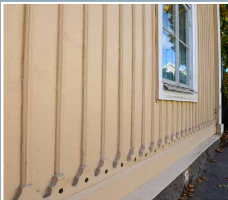
Profilen på lockläkt går lokalt under namnet Askersundsläkt, här på prästgården i Askersund. Notera även den utsmyckade sockelbrädan.
